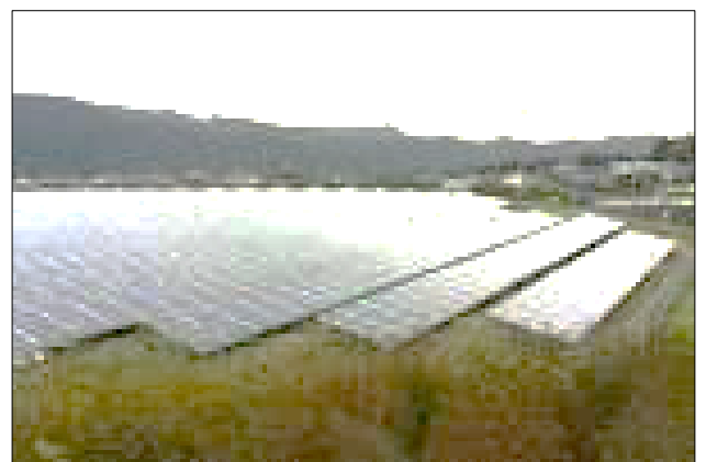
愛川太陽光発電所
